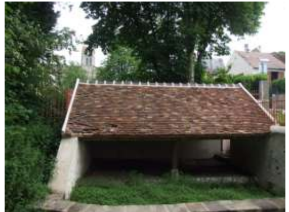
La toiture du lavoir endommagée que nos petits éco-citoyens ont relevé au cours de leur promenade
